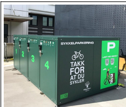
Eksempel på sykkelparkering etablert i 2022 - 8 sykkelskap ved Pirbadet
